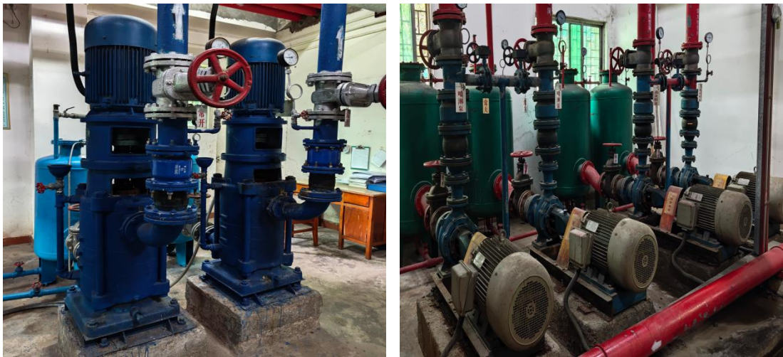
图 6-16 生活水泵和消防水泵
