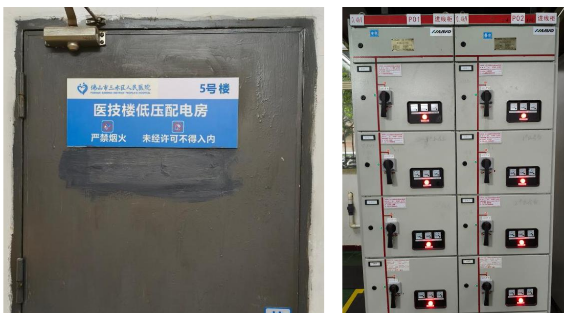
图 6-5 人民医院 2 号专用配电站低压房实景照片
