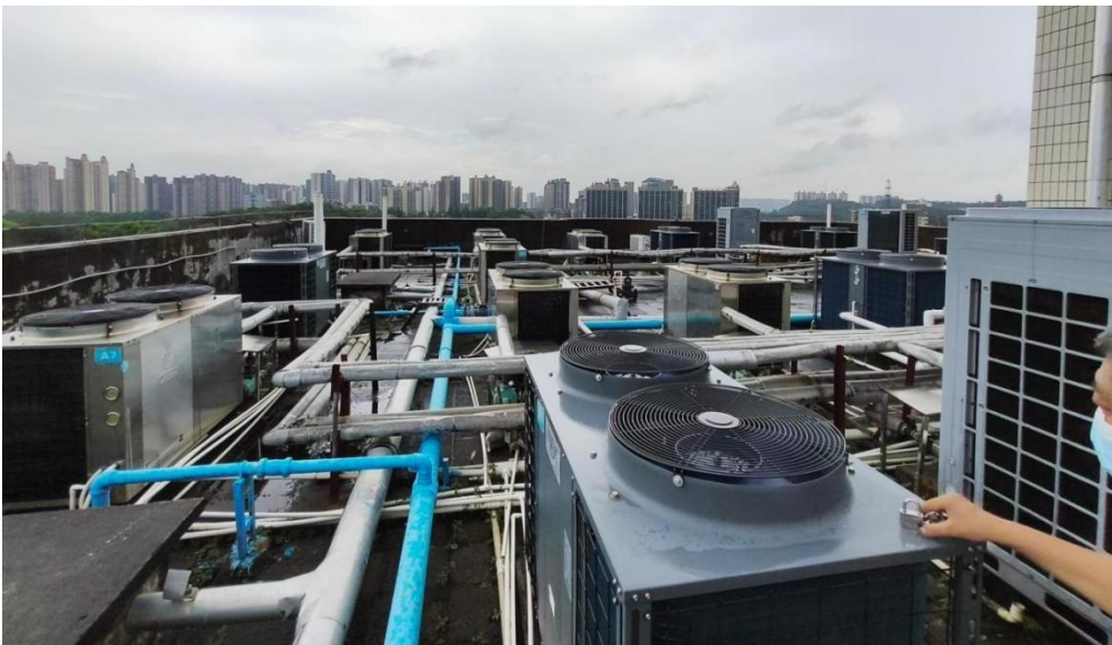
图 6-17 住院楼楼顶空气能供热系统放置实景
