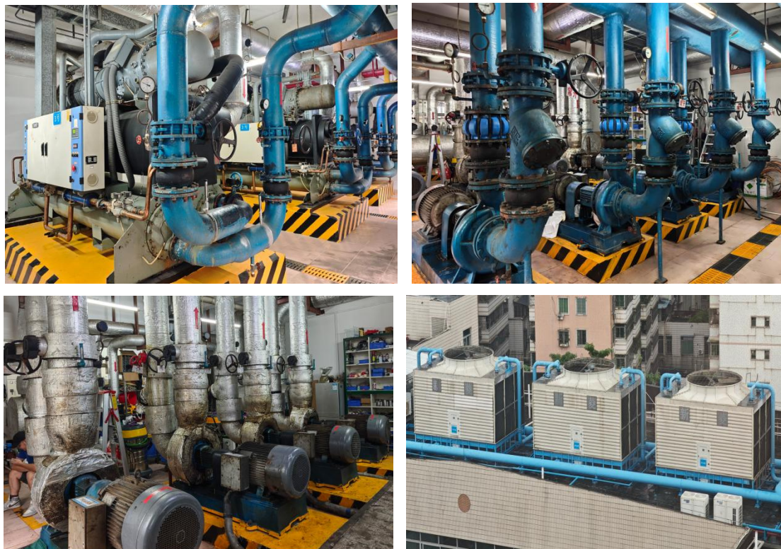
图 6-10 中央空调冷站现场照片
