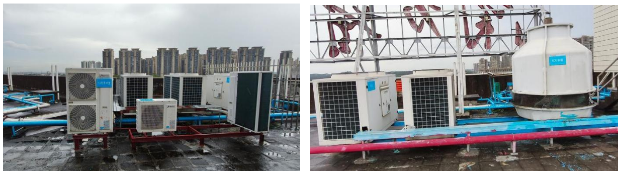
图 6-9 医院洁净空调室外机现场
