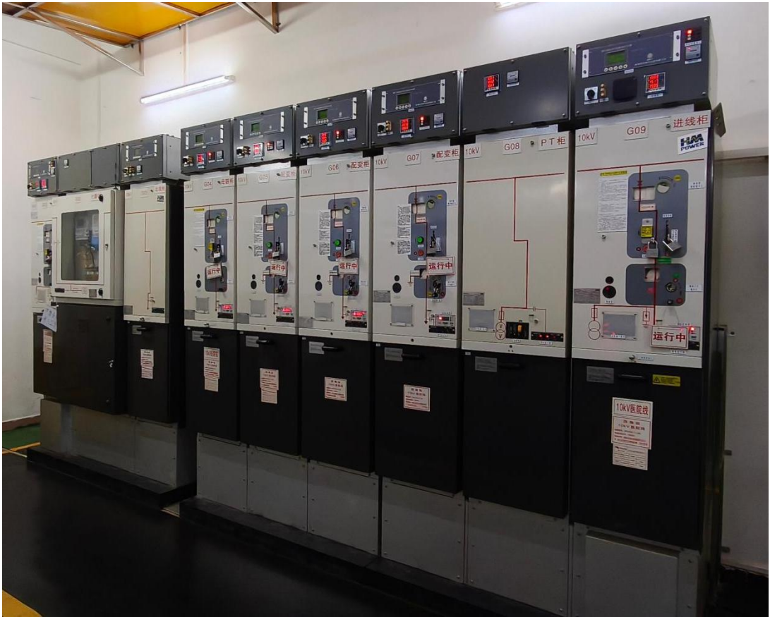
图 6-6 人民医院 2 号专用配电站高压房实景照片
