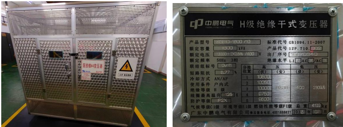
图 6-7 人民医院 2 号专用配电站医技楼 4 号变压器实物及其铭牌
